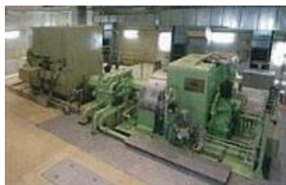
発電設備（東淀工場）
