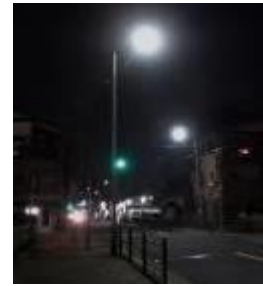
道路照明灯のLED照明
