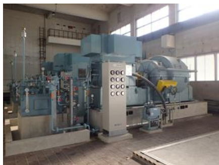
送風機（ブロウ）（平野下水処理場：平野区）
