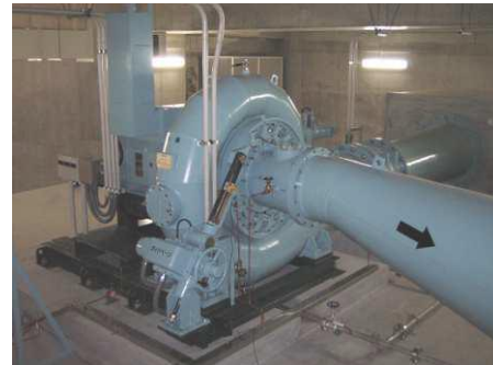
小水力発電設備 (長居配水場：東住吉区)
