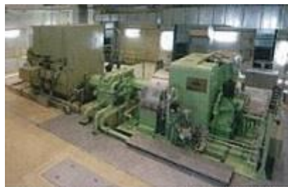
発電設備（東淀工場）
