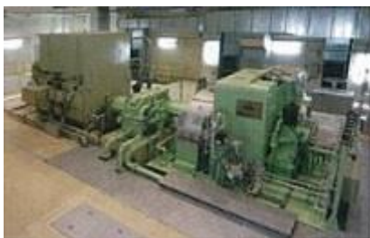
発電設備（東淀工場）
