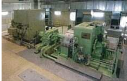
発電設備(東淀工場)
