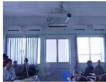
高効率エアコン及びEMS (ベトナム)
