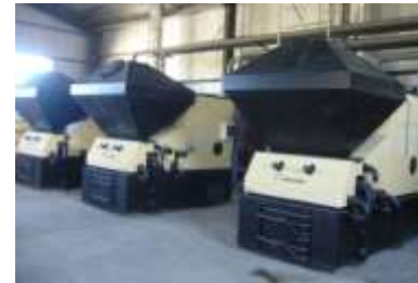
暖房用の高効率ボイラ (モンゴル)
