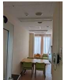
照明消灯 （部屋不使用時）
