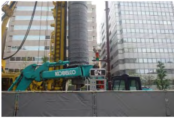
写真 8.9 騒音・振動の計測・表示
