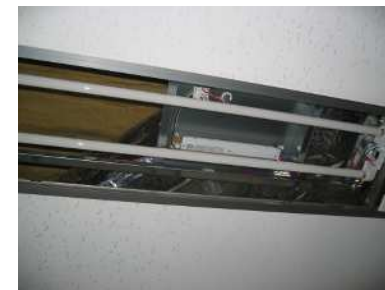
器具内に古い安定器が残っている例
