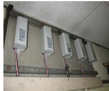
工場等の壁際に設置されている例
