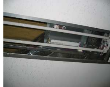
器具内に古い安定器が残っている例
