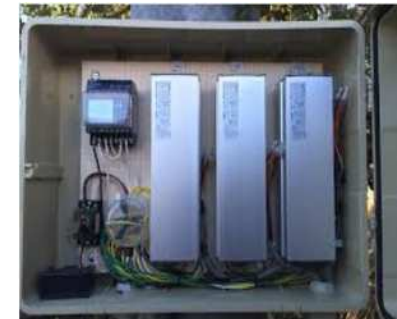
安定器BOXに収納された安定器
