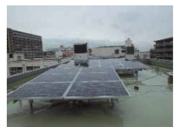
屋上に設置した太陽光発電設備
