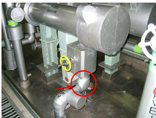
【機器・配管の外観】
