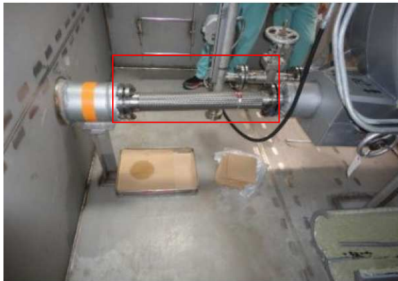
溶媒漏洩箇所
