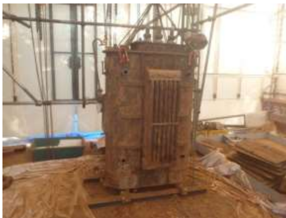
大型トランスの全貌
