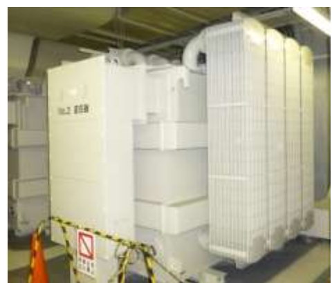
ビル地下6階の大型トランス
