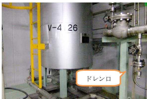
オフスペック廃木酢液槽
