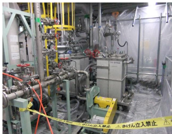
5%NaOH 水溶液タンク
