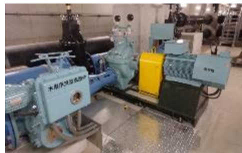
咲洲水力発電設備
