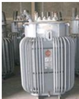
高圧トランス
