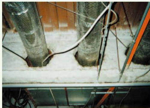
耐火被覆用吹付け石綿・石綿含有吹付けロックウール（S造の柱・梁等）
