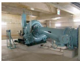
長居水力発電設備
