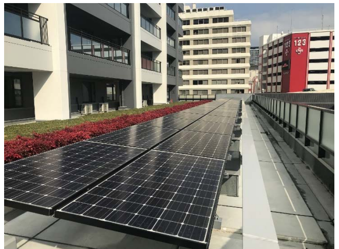
写真6：太陽光発電パネル
