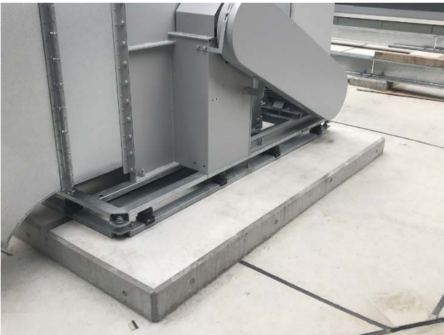
写真3：設備機器防振架台
