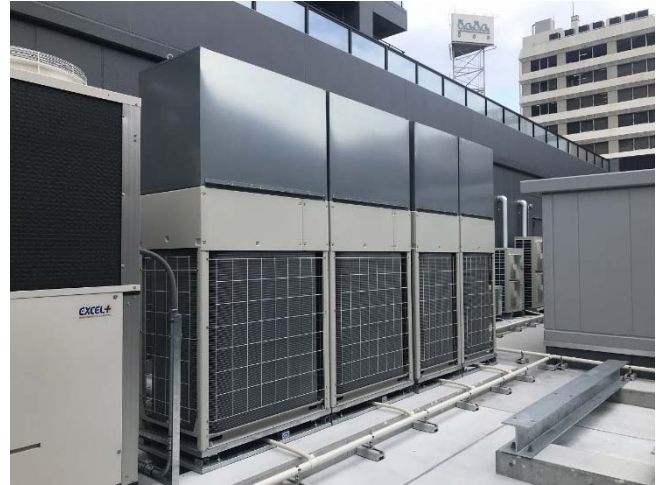
写真2：空調設備消音装置
