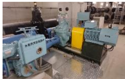
咲洲水力発電設備
