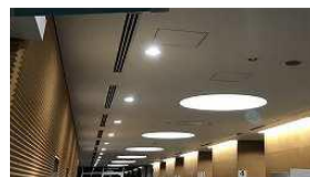
区役所フロアのLED照明
