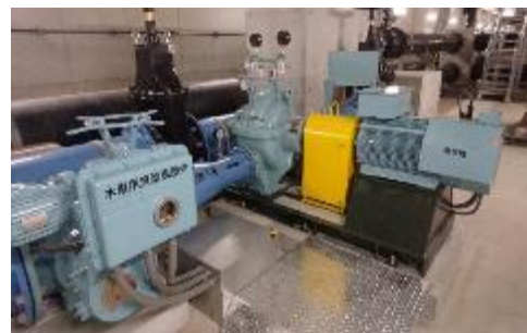
咲洲水力発電設備
