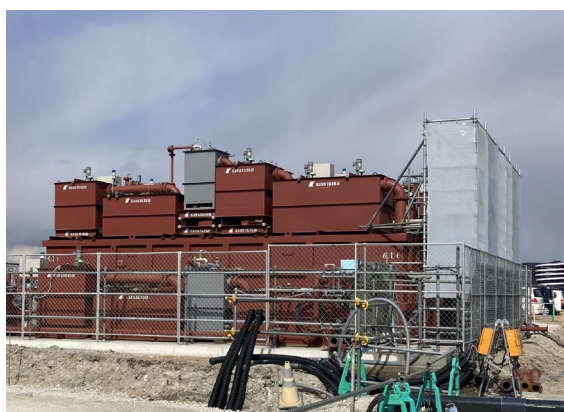
写真5 工事排水の pH 処理装置
