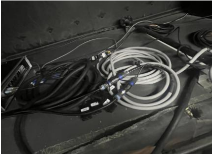
・引き回しケーブルチェック・留め具確認
