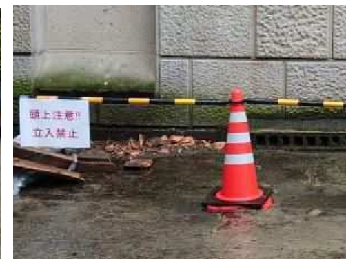
◆ 笠木崩落状況
