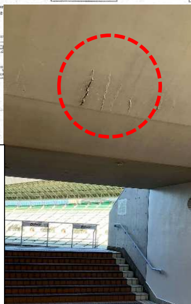
外装劣化状況（コンコース外壁）
