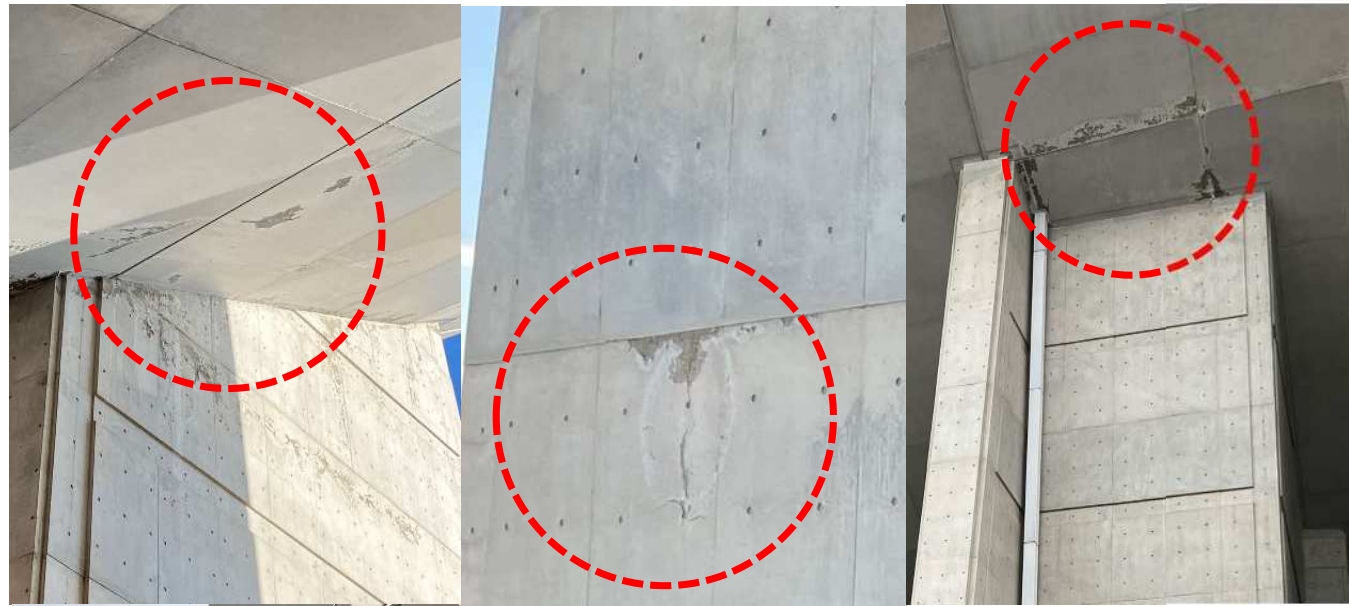
外装劣化状況（外壁）
