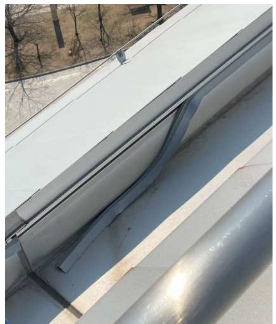
【現況写真 軒樋水切りゴム劣化状況】
