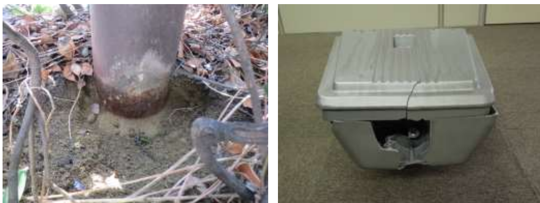
参考写真4-1 地際部における損傷や過度の振動による損傷事例
