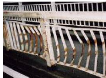
損傷区分「e」 (著しい変形)
