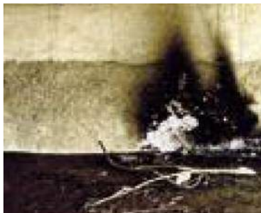
損傷区分「e」 (火災による変色)
