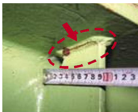
損傷区分「e」 （塗膜割れ、錆）
