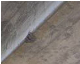
損傷区分「c」 (欠損)
