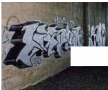
損傷区分「e」 (落書き)
