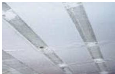
損傷区分「c」 (遊離石灰)
