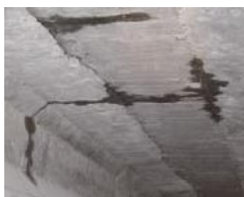
損傷区分「c」 (漏水)
