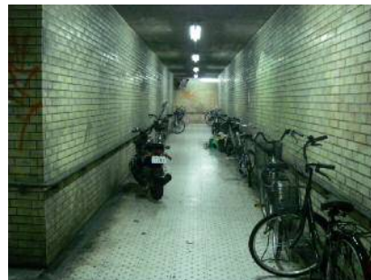
損傷区分「e」 (不法占拠)
