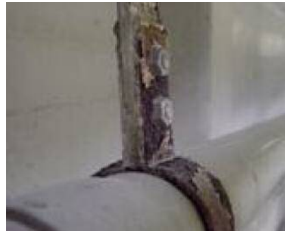
損傷区分「e」 (板厚減少、広範囲腐食)
