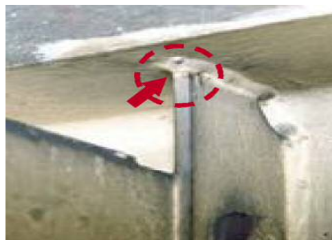
損傷区分「c」 （接合部、塗膜割れ）
