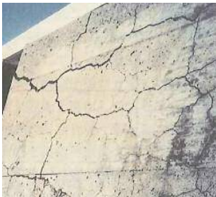
亀甲状のひび割れ
