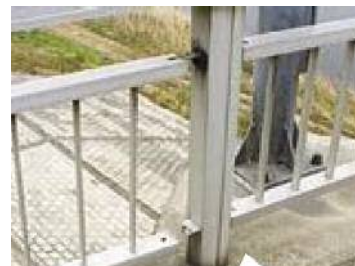
損傷区分「e」 (継手部が破断)
