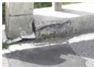
損傷区分「e」 (著しい欠損)
