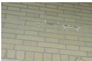
損傷区分「d」 (遊離石灰)
