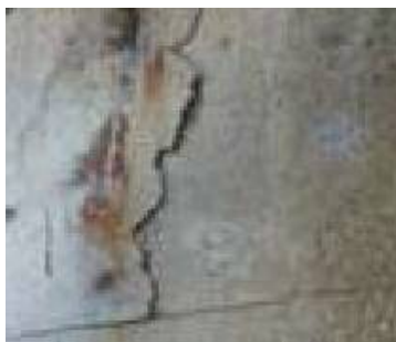
損傷区分「d」 (浮き)
