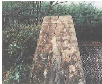
鉄筋方向に沿ったひび割れ
