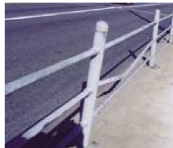
損傷区分「c」 (変形)
