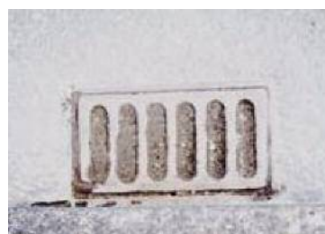
損傷区分「e」 (土砂詰り)
