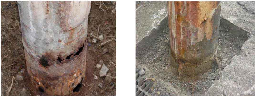
写真-2.2 路面境界部の腐食事例
