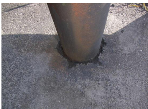
腐食、路面付近での滞水
