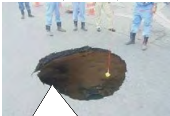
道路陥没の事例 (H18年8月港区)
