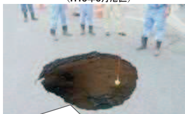
道路陥没の事例 (H18年8月港区)
