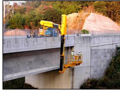
④橋梁点検車
