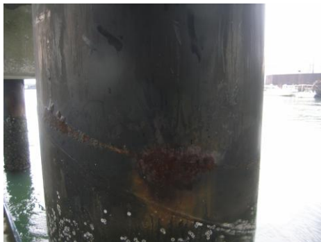
（参考）損傷区分 C
