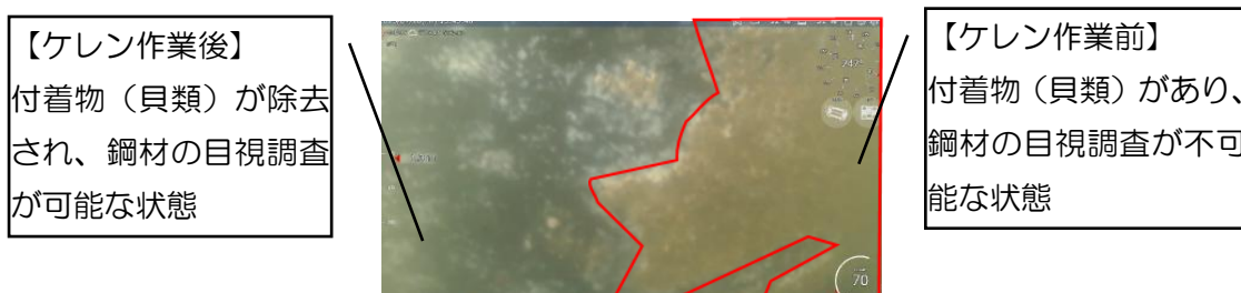
図 2.5 鋼製パイルベントの付着物状況（静波橋）
