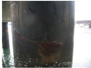
（参考）損傷区分 C
