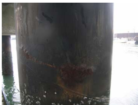
（参考）損傷区分 C
