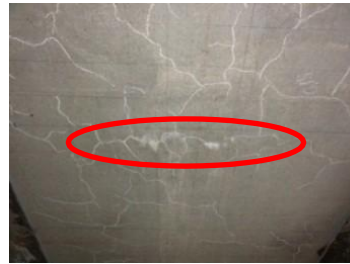
貫通ひびわれあり
