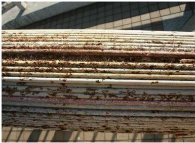
上面 素線間に溝あり ケレン前
