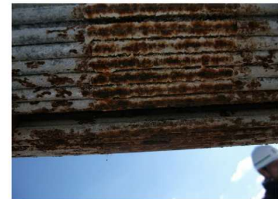
内層素線確認 (下面ｸﾞﾙﾞ割り)
