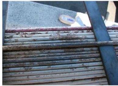
錆が目立つ箇所
