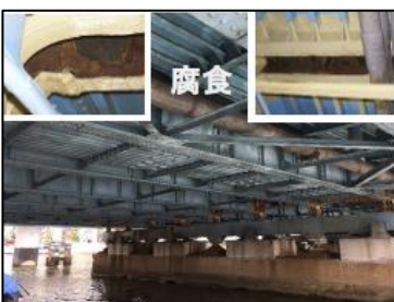
▲特殊部位の腐食
