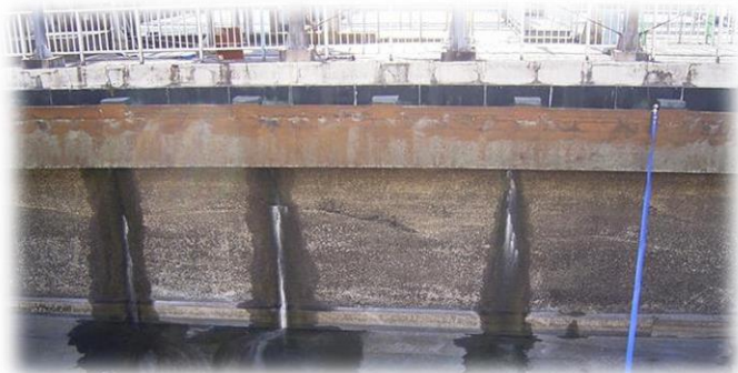
水処理施設の漏水
