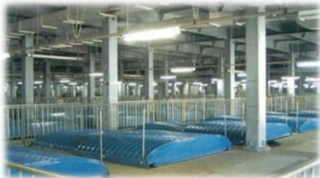
水処理施設における二重覆蓋
