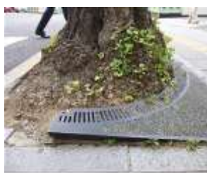
根上がりによる施設損壊
