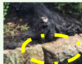
根により擁壁が押されている状況 （将来的に損壊するおそれあり）
