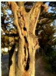
腐朽の進行による腐朽部の露出
