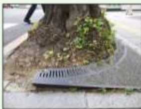
大径木化による歩道損傷（根上り）
