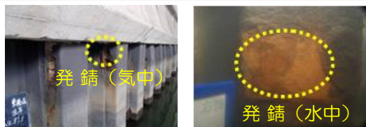
＜鋼矢板護岸の劣化状況＞
