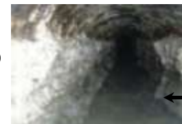
下水管内に油分が付着している
