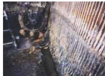
老朽化した機械スクリーン設備
