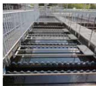
沈澄池(最終沈殿池)
