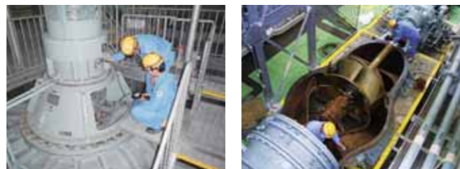
雨水ポンプの診断
