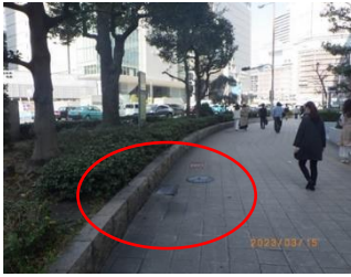
歩道平板の陥没
