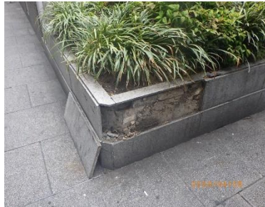
植栽柵の破損
