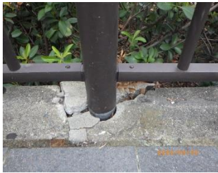
横断防止柵の欠損
