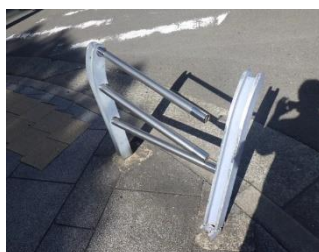
横断防止柵支柱の折損
