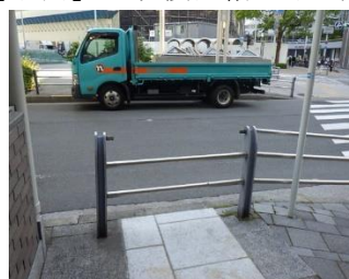
横断防止柵の破損
