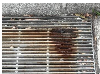
グレーチング劣化
