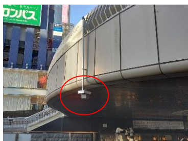
戎防犯カメラ(戎橋下)
