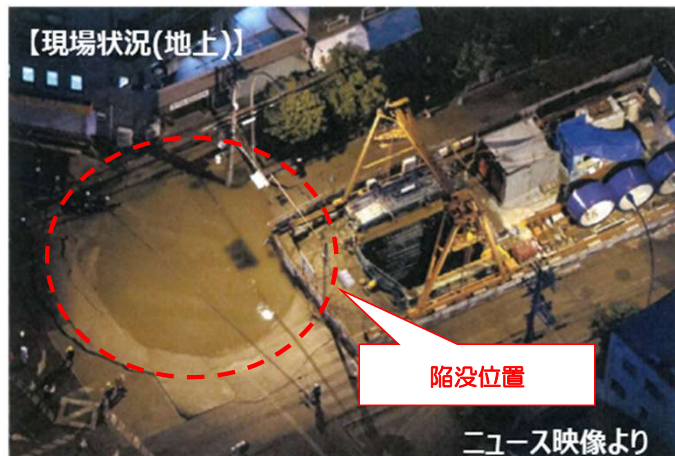
(写真1) 事故発生時道路陥没状況写真
